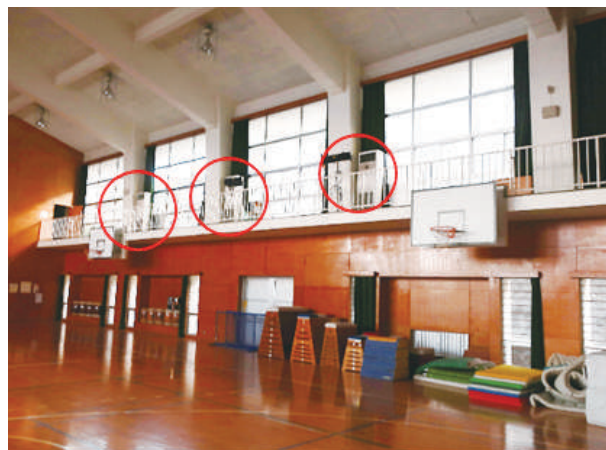
助言を参考に新設された体育館の空調設備
