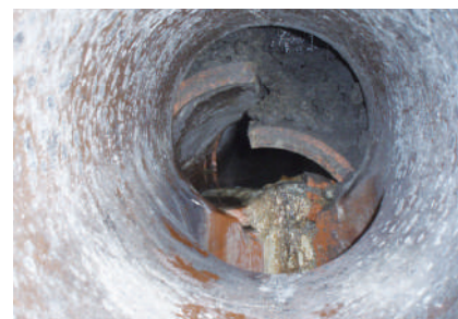
老朽管の破損状況（下水道管が割れてずれている状態）
