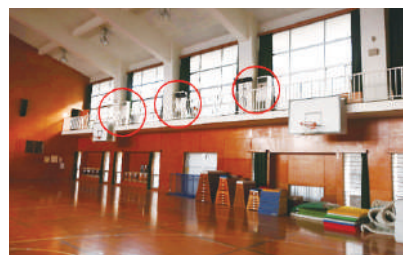
助言を参考に新設された体育館の空調設備
