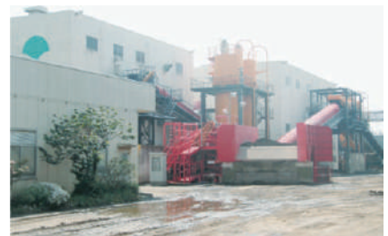
土質改良プラント
