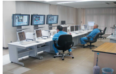
中央監視盤室
